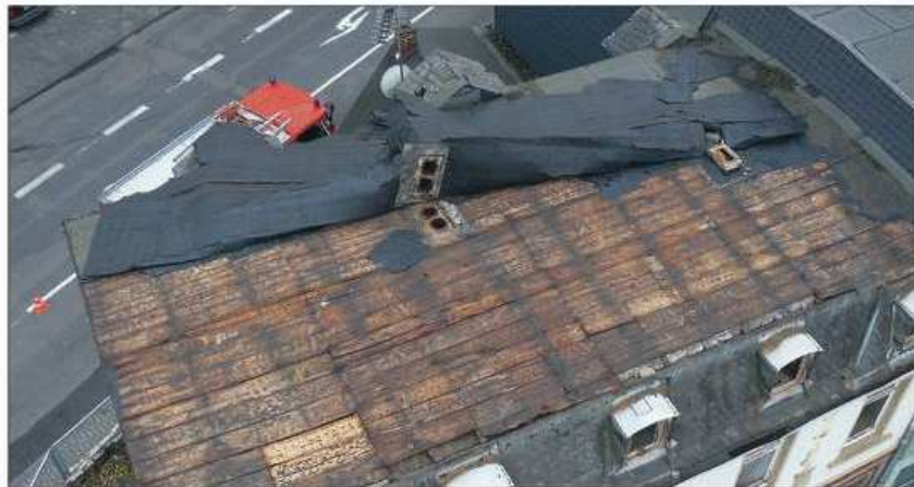
Auch im Stadtgebiet von Koblenz wütete der Orkan „Emma“ mit Urgewalt. Die Feuerwehr wurde zu 13 Einsätzen wegen Gebäudeschäden gerufen. Wie von einer gewaltigen Faust wurde dieses Dach in Koblenz-Lützel abgedeckt. Foto: Feuerwehr
